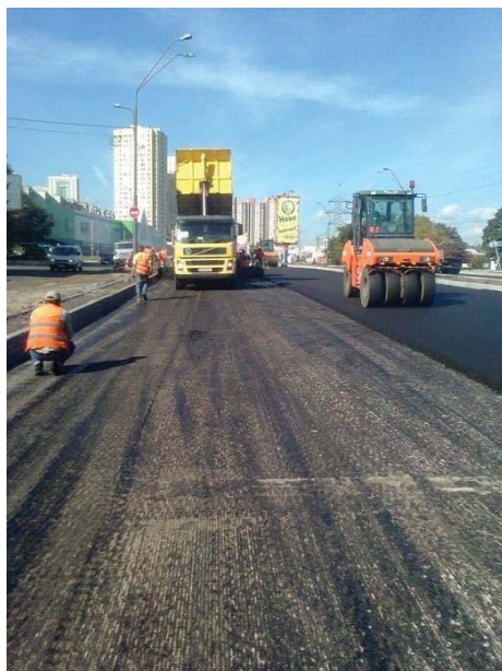
Рис. 2. Порушення технології очищення основи від бруду і пилу перед виконанням підґрунтовки
