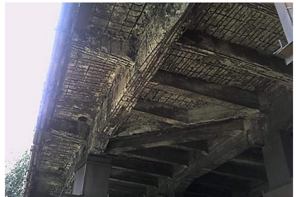
Рис.1. Корозійні пошкодження залізобетонної прогонової споруди автодорожнього шляхопроводу на території Маріупольського металургійного комбінату «Азовсталь» внаслідок впливу газоподібного агресивного середовища з підвищеним вмістом кислих газів (вуглекислого газу CO_2 і сірчаного ангідриду SO_2 )
