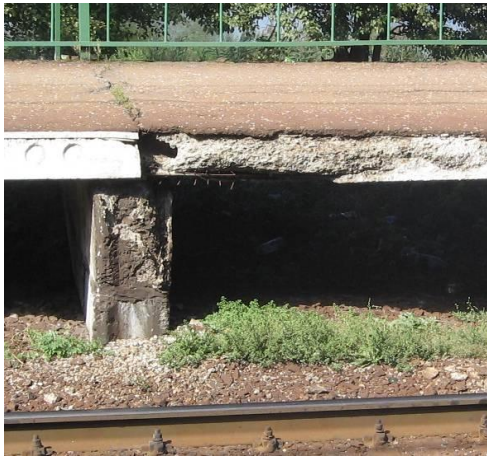
Рис. 2 - Разрушение железобетонной плиты
