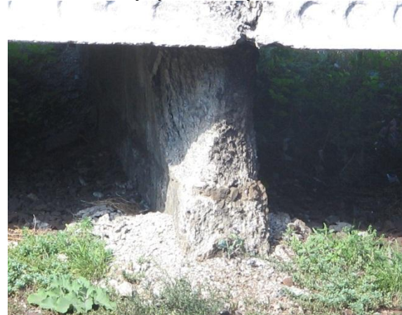
Рис. 1 - Разрушение торцов и боковых граней
