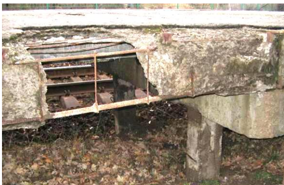
Рис. 3 - Вертикальные трещины в стойке и разрушение ребер плит высокой платформы
