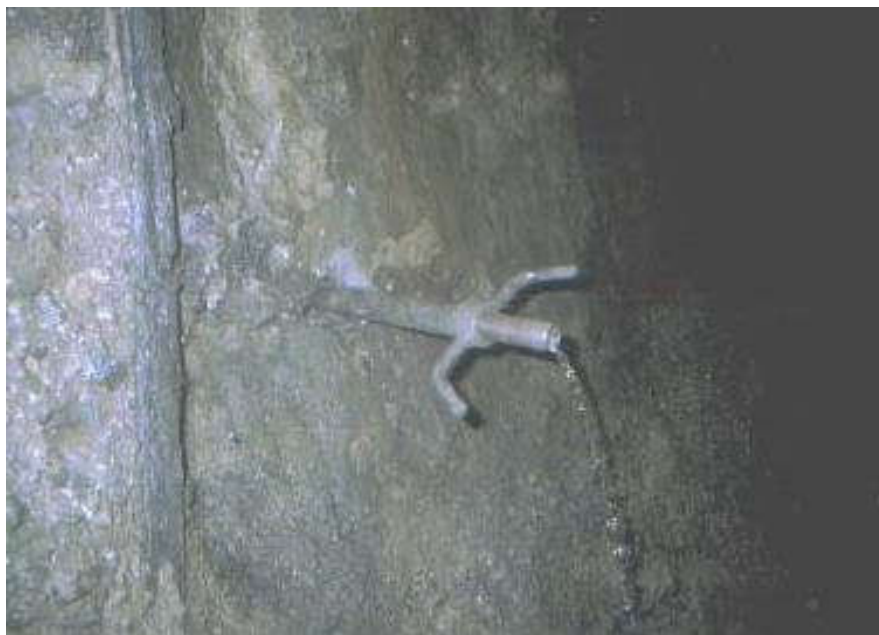
Рис. 1. Витікання води через ін'єктор, встановлений в шпарину, просвердлену в обробці тунелю до заобробкового простору
